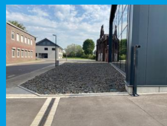
Schottermulde als Überflutungsfläche
